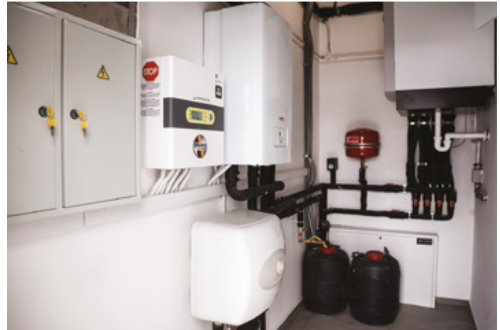
• Система теплового насоса «повітря/вода»
