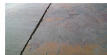
Підлога до ремонту
